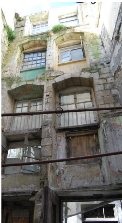
Figura 4.59 – Janela da fachada frontal (Porto Vivo, SRU)
