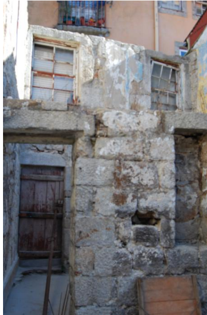
Figura 4.60 – Janela da fachada de tardo (Porto Vivo, SRU)
