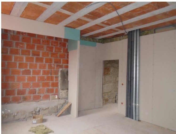
Figura 5.4 – Paredes divisórias e de recobrimento constituídas por gesso cartonado
