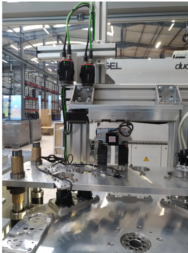
Figura 4.33: Estrutura real do sistema de visão para verificação e medição
