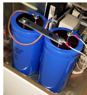
Figura 78- Condensadores com capacidade de armazenar até 450 volts contínuos cada.
