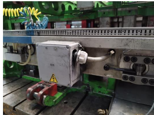
Figura 42 - Caixa de distribuição de sinais e alimentação elétrica do sistema transfer com conexão partida.
