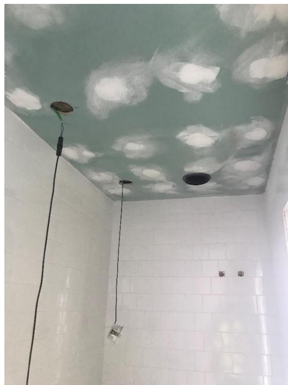
b) Pintura do teto incompleta
