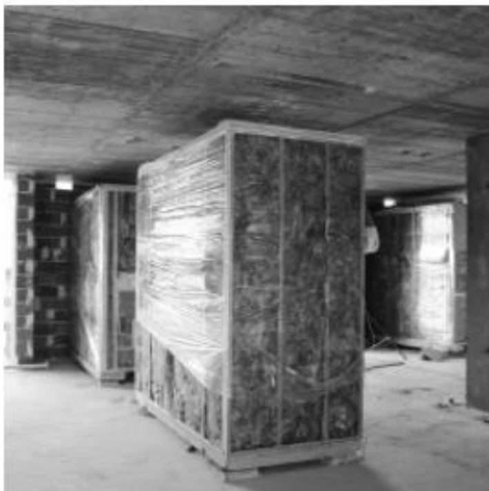
Figura 4-7 Colocação do monobloco nos apoios definitivos e nivelamento recorrendo a bases de neoprene, (Transmodulo, 2022)
