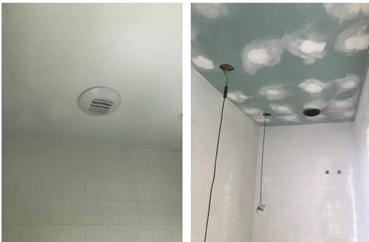
a) Casa de banho com respirador instalado
