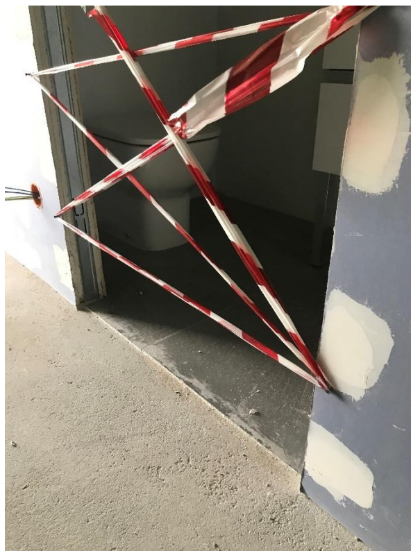
b) Tijoleira mal colocada (antes da alteração)
