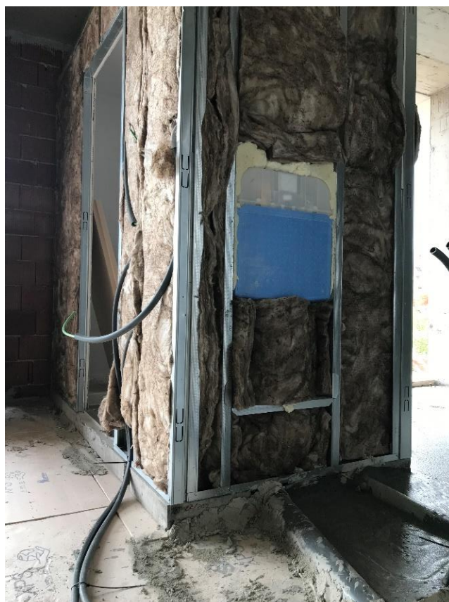
Figura 4-9 Colocação de XPS no piso e acabamento da base do monobloco para posterior betonagem do betão leve, (autor do trabalho)
