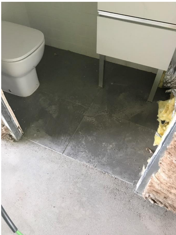
a) Tijoleira sem danos na tijoleira
