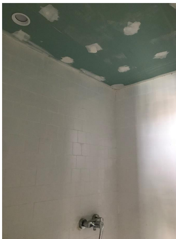
b) Ausência do apoio do chuveiro
