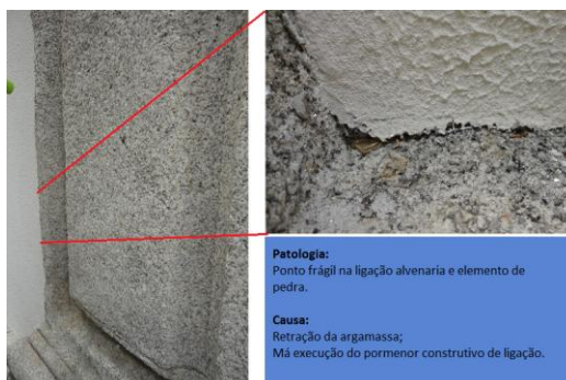
Figura 5 - Imagem elucidativa de anomalia verificada em zona de ligação
