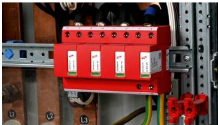
Figura 70 – Instalação de um Descarregador de Sobretensões num Quadro Elétrico
