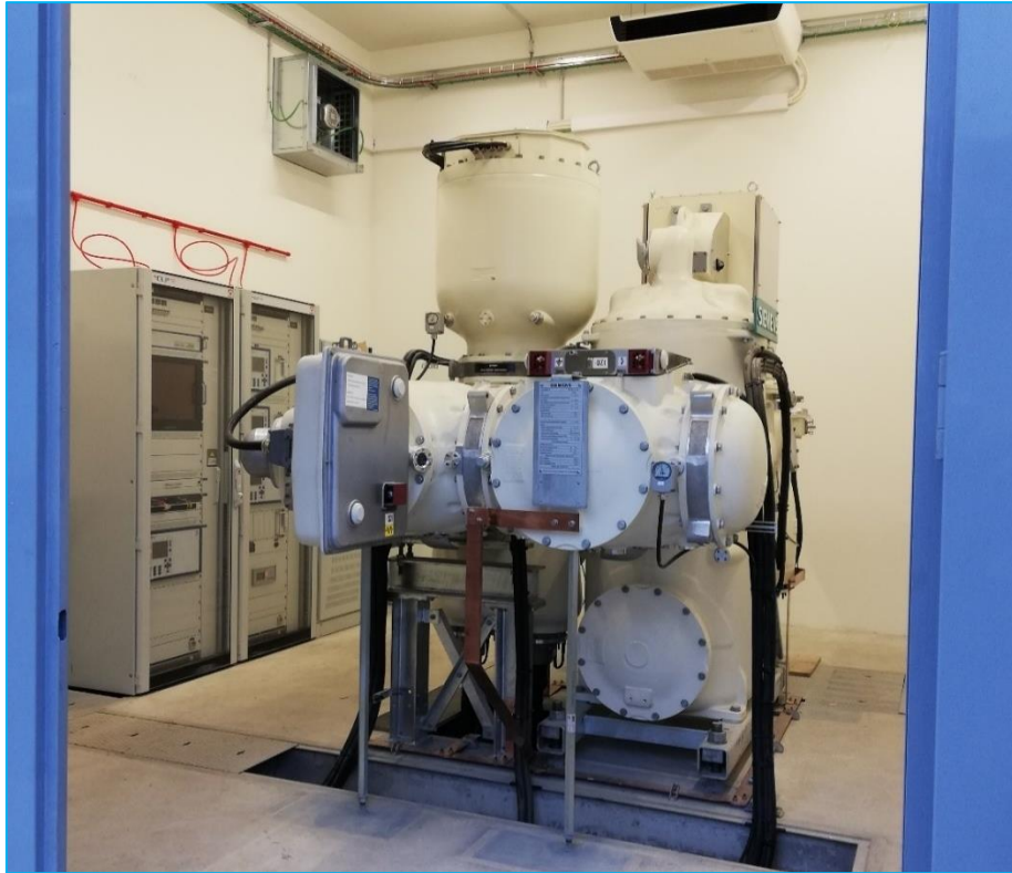
Figura 3.16-Subestação tipo GIS, Superbock Group, Leça do Balio
