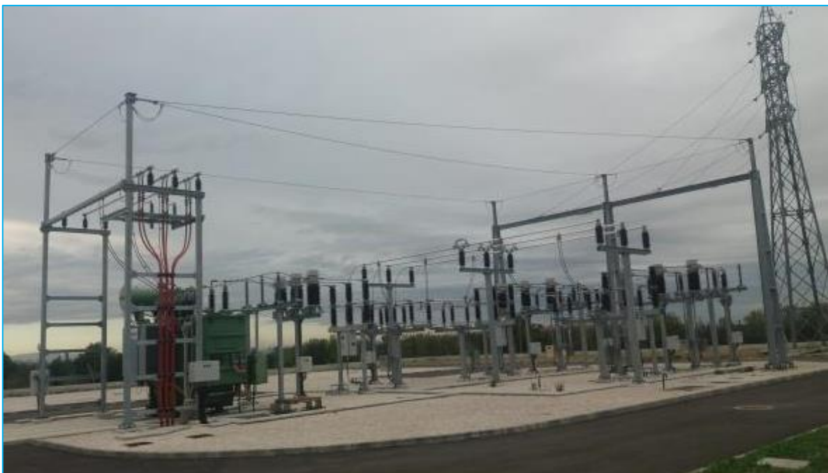
Figura 3.15-Subestação de Benavente do tipo AIS, E-Redes [44]
