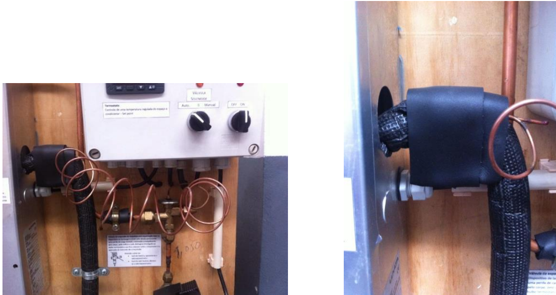
Figura 25 – Válvula termostática instalada (1) com o bolbo devidamente isolado (2).
