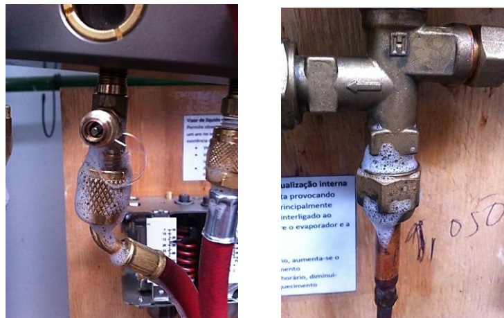
Figura 62 – Fuga de fluido (1) e circuito estanque (2).
