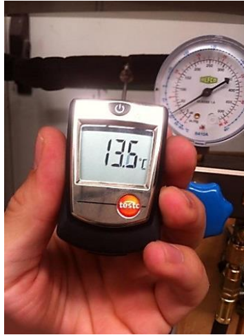
Figura 66 – Temperatura à chegada ao compressor.
