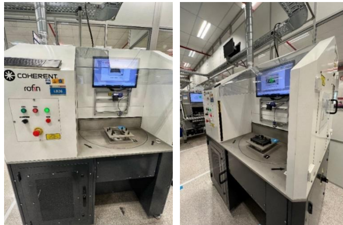
Figura 30 - Equipamento de marcação laser de fibra ótica instalado na linha 2W02
