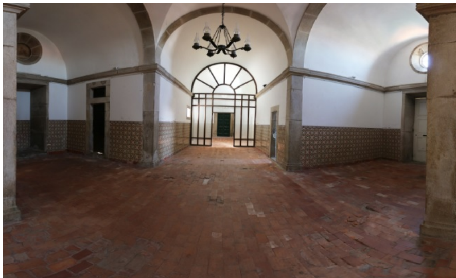
Figura 100 - Piso danificado no Corredor Celas dos Monges
