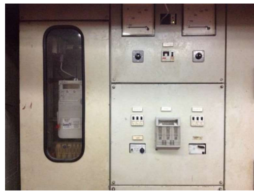
Figura 28: (Verificação do Contador)
