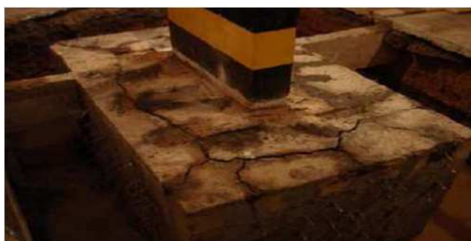
Figura 13: Bloco de fundação de um edifício com nove anos de idade com padrão de fissuração típico de RAA (Andrade, 2006).
