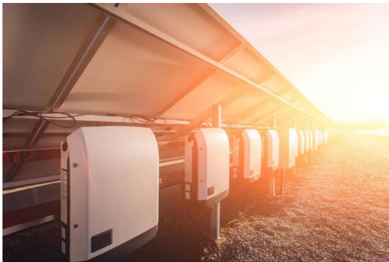
Figura 2.12: Inversores solares num parque fotovoltaico[40].
