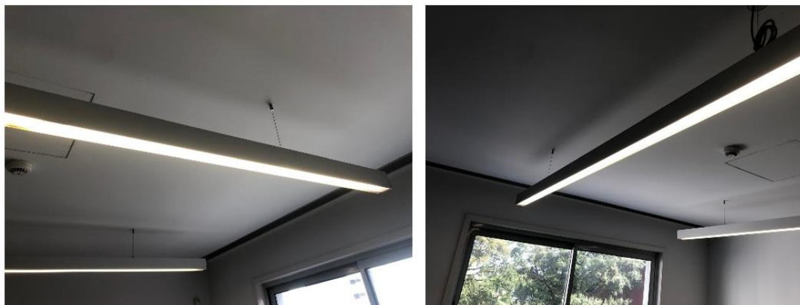
Figura 3.5: Luminárias atuais no Gabinete 2.9.
