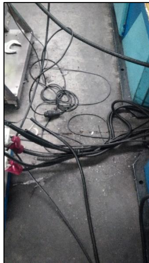
Figura 58: Antes da arrumação dos cabos elétricos
