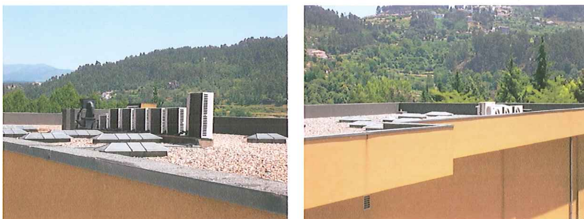
Foto 2 Sistema AVAC exterior na cobertura
