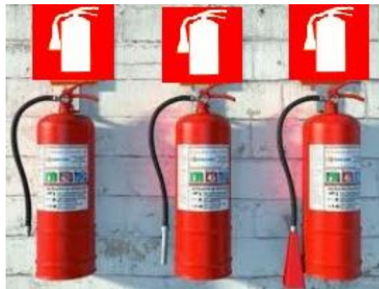
Figura 5-6 – Extintor sinalizado (Autoria própria)
