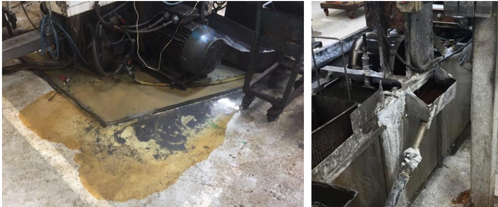
Figura 58 - Zonas com défice de manutenção e limpeza (piso e equipamento)
