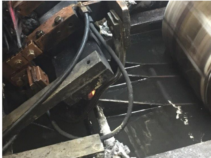
Figura 40 - Tanque de água e sal da têmpera
