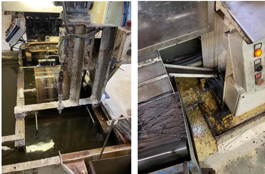
Figura 59 - Zonas degradadas com a falta de manutenção e limpeza (piso e máquinas)
