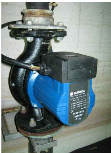
Figura 28 Bomba de circulação
