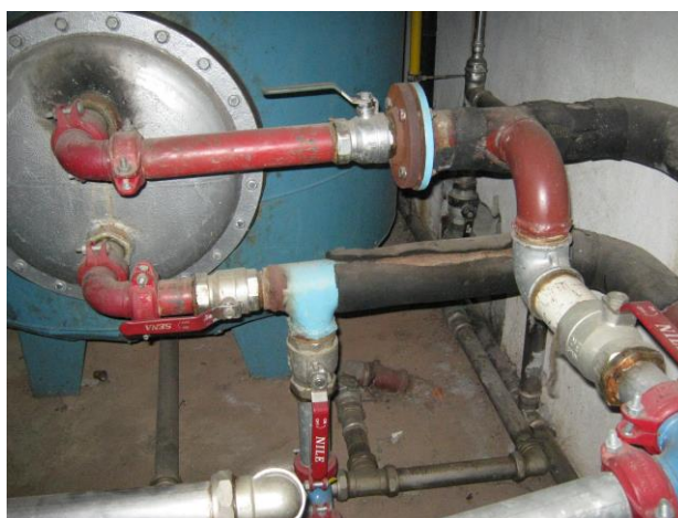
Figura 48 Exemplo de tubagens com isolamento térmico degradado
