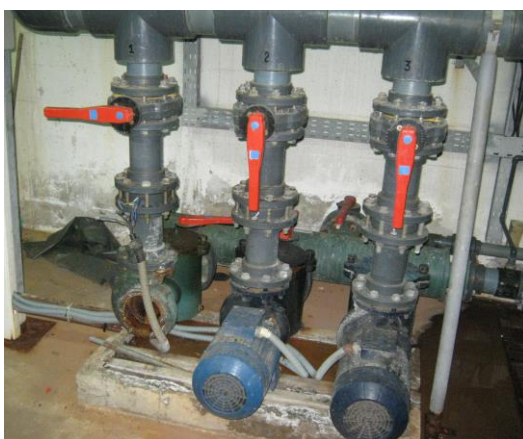
Figura 29 Bombas de tratamento
