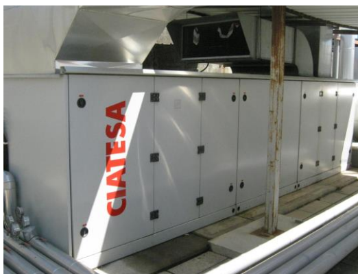
Figura 25 Unidade de tratamento de ar
