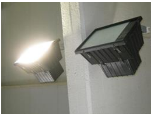
Figura 30 Iluminação da nave
