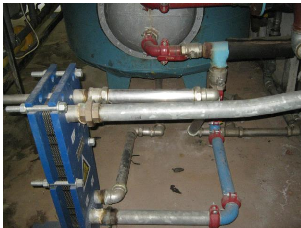
Figura 47 Exemplo de tubagens sem isolamento térmico
