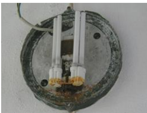
Figura 32 Iluminação da nave
