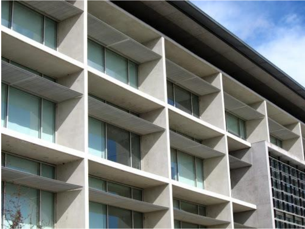
Figura 3.11 – Palas horizontais de um edifício de habitação na Califórnia, E.U.A. [Fonte: Bill Burke]
