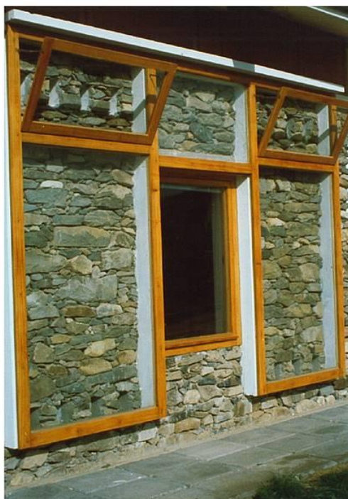
Figura 3.15 – Parede de Trombe, Camacha, Porto Santo [Fonte: solidararchitekten (2012)]
