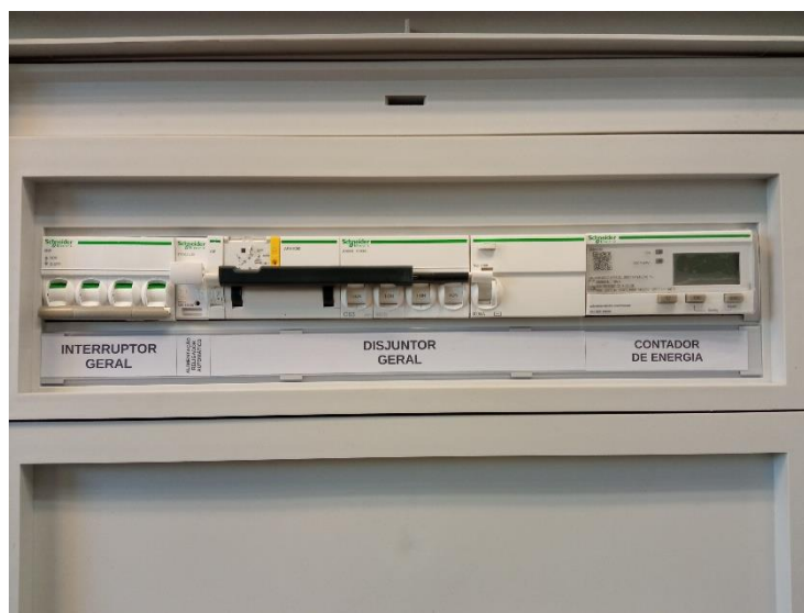
Figura 3-Componentes elétricos. Fonte Própria.
