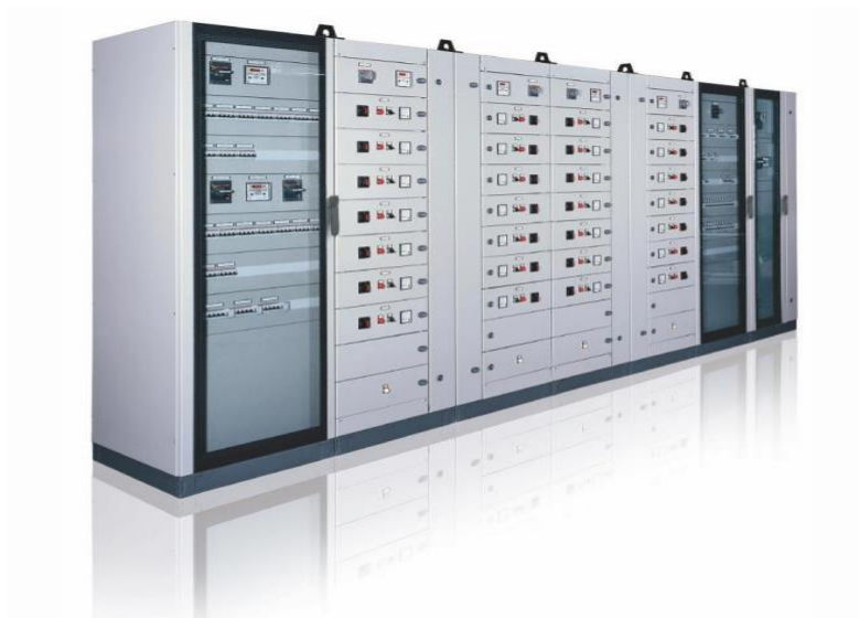
Figura 8- Conjunto elétrico ABB. Fonte:[16]
