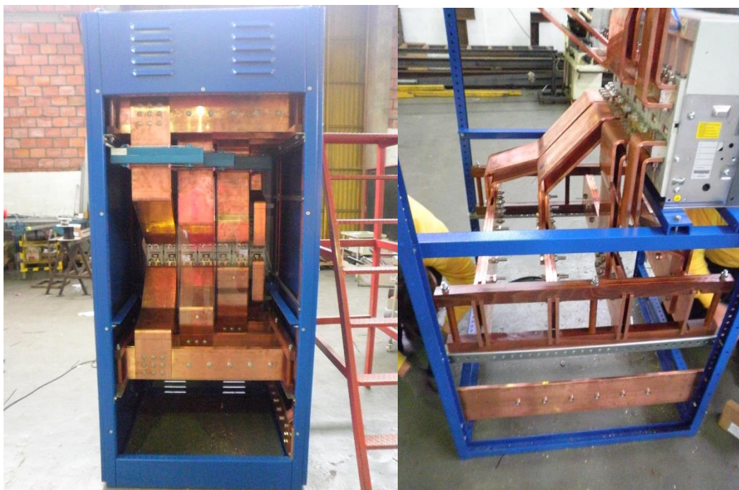
Figura 4- Barramento em um quadro modular de BT. Fonte: Jayme da Costa
