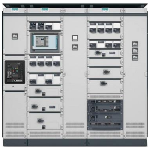
Figura 27- Quadro elétrico Siemens[17]
