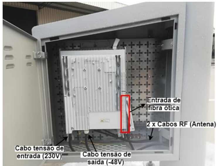
Figura 67: Equipamento de telecomunicações (RRU) inserido no armário de expansão.
