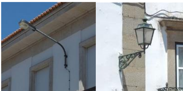
Figura 13: Luminária em fachada [12]
