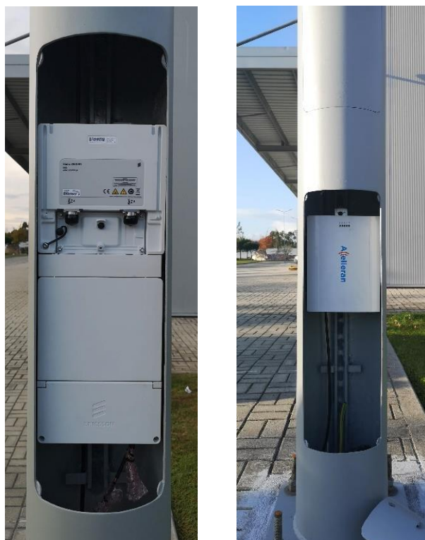
Figura 61: Small Cell Ericsson 4G Plus (lado esquerdo) e Small Cell 4G Acelleran (lado direito) instaladas no interior da coluna de Iluminação Multisserviços
