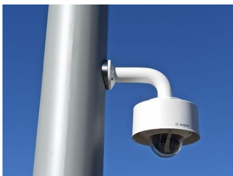
Figura 54: CCTV instalada na coluna de Iluminação Multisserviços
