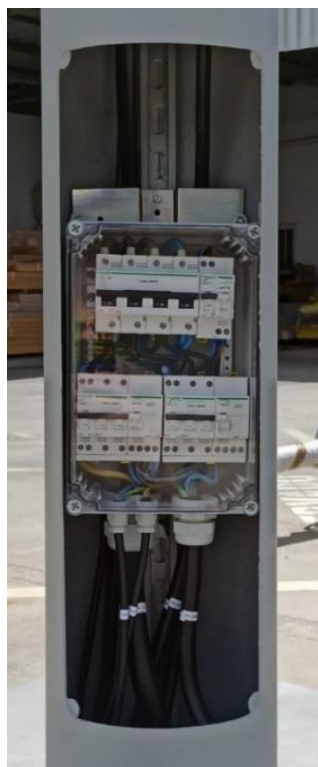
Figura 65: Quadro elétrico instalado no interior da coluna de Iluminação Multisserviços.
