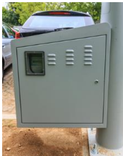
Figura 66: Armário de expansão acomodado na coluna de Iluminação Multisserviços
