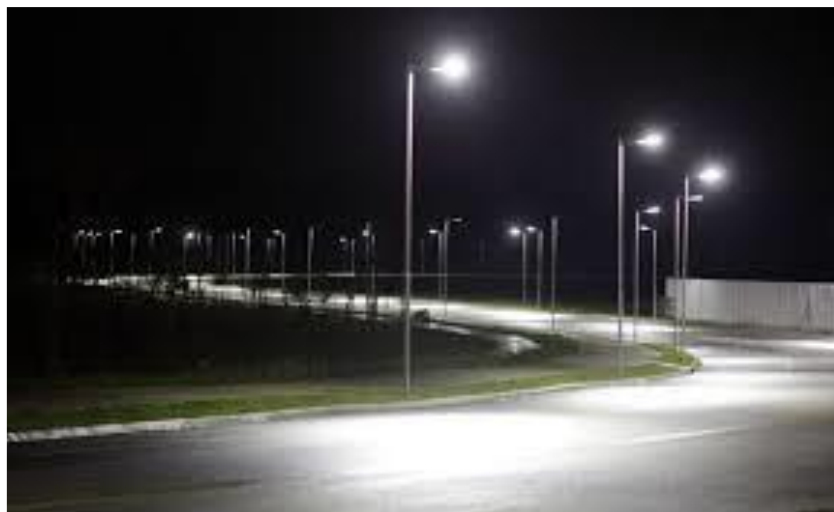
Figura 25: Via pública iluminada por tecnologia LED [20]
