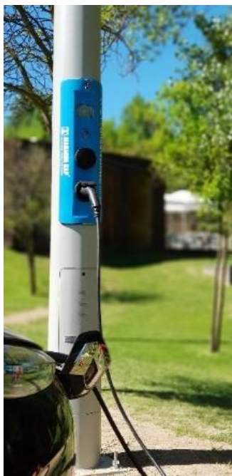
Figura 60: Carregador de VE incorporado na coluna de Iluminação Multisserviços
