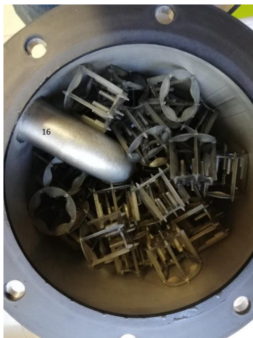
Figura 4-7: Tanque de retenção de condensados com enchimento e água
