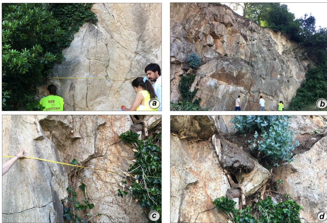
Figura 4.5 – Aspetos gerais do talude rochoso dos Escuteiros, Santo Ovídio (Vila Nova de Gaia): a) zona mais alterada do maciço; b) aplicação da técnica de amostragem linear (“scanline”); c) presença de raízes no interior de descontinuidades; d) evidência de um bloco isolado existente no talude.
