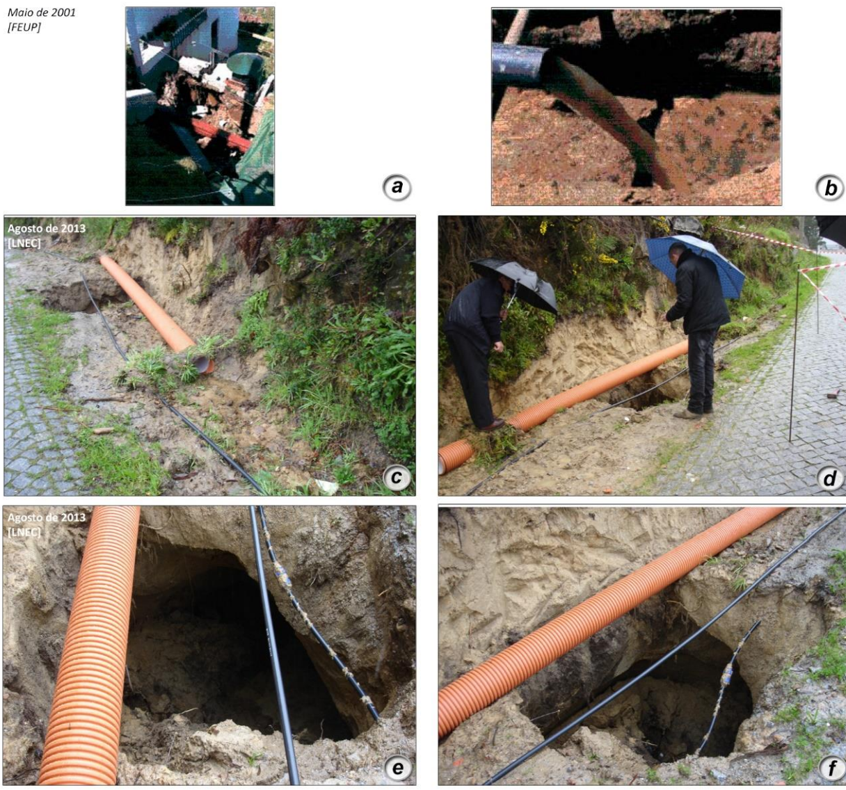
Figura 6.5 - Ilustração dos abatimentos (ou aluimentos) com a observação das chaminés (ou óculos) do Monte do Fijô: a), b) – relatório do DM|FEUP (maio de 2001); c) a f) – relatório do LNEC (agosto de 2013) e arquivo CMC.
