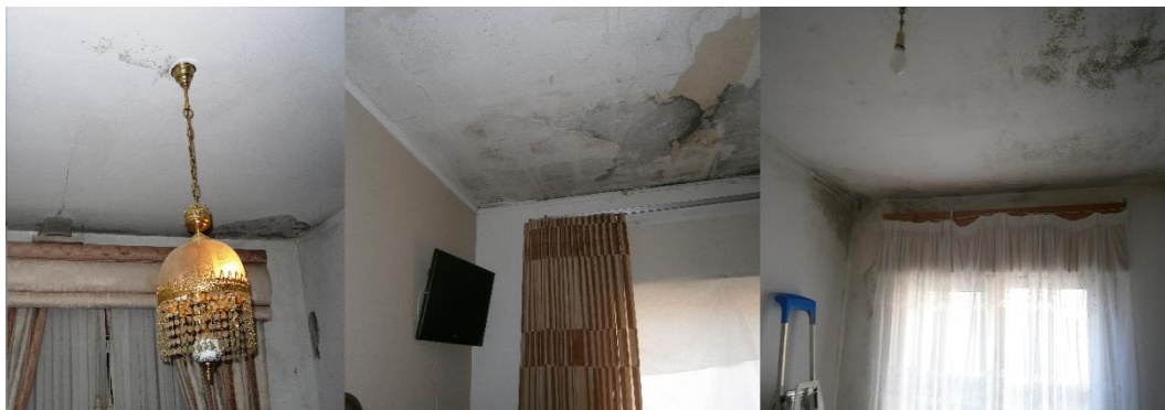
FIGURA 12- ALGUMAS PATOLOGIAS ENCONTRADAS NO INTERIOR DAS HABITAÇÕES
