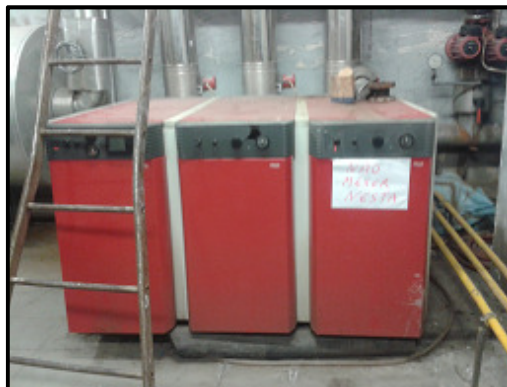
Figura 28 – Fotografia do sistema de aquecimento.
