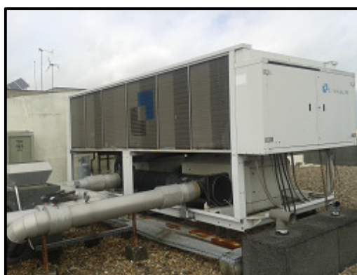
Figura 29 – Fotografia do chiller responsável pelo arrefecimento.
