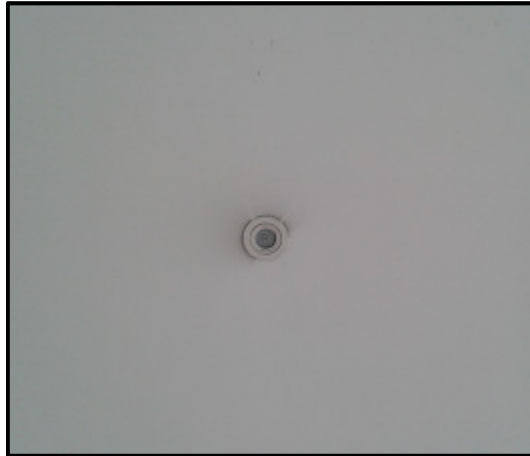
Figura 25 – Fotografia da armadura de iluminação de 50W.
