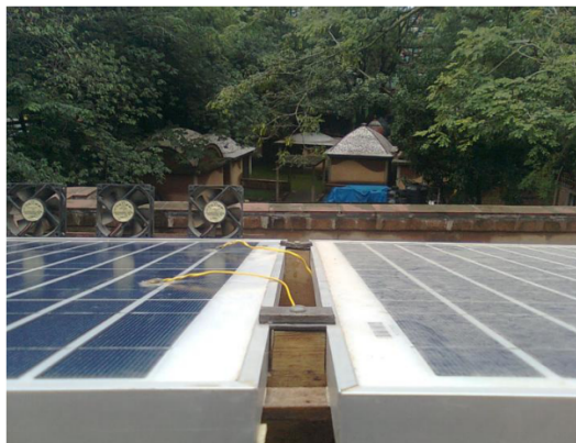
Figura 2.25: Acumulação de poeira num painel solar [51]
