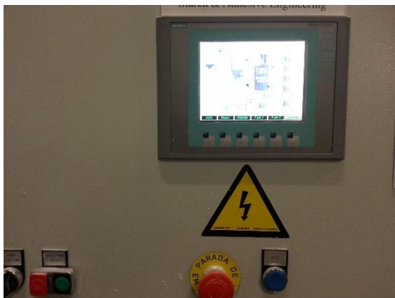
Figura 20 - PLC da cozinha (Calheiros Embalagens, 2017)
