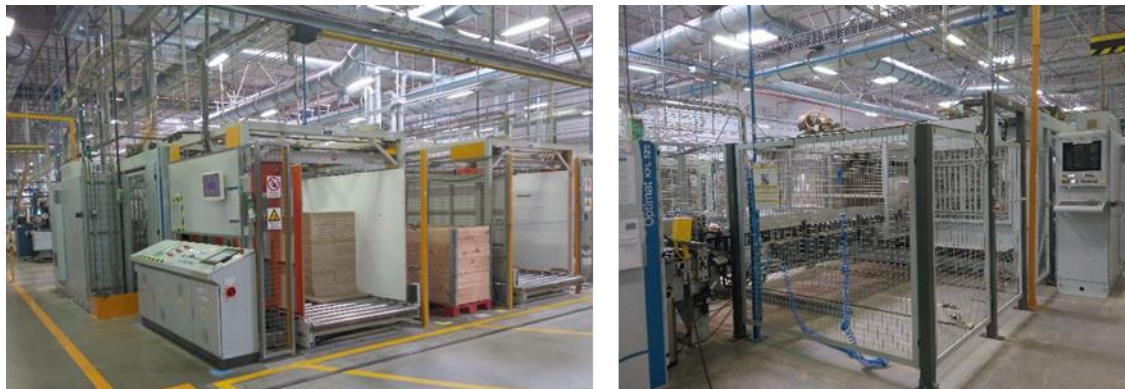
Figura 33 RBO de Entrada (à esquerda: os conveyors de carga de paletes; à direita: o conveyor central)
