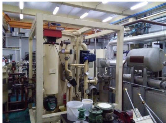
Figura 25 - Equipamentos de tratamento e enchimento de óleo
