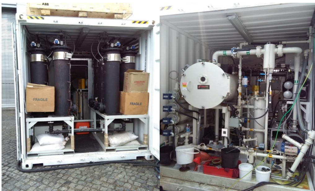
Figura 26 - Unidade de tratamento e enchimento de óleo
