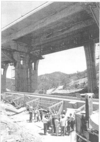
OS OPERÁRIOS, NOS FUNDOS, E DOIS GRUAS, FICARAM SOBREVIVENTES DE UM COLAPSO DE UMA VÉSTIBULA
