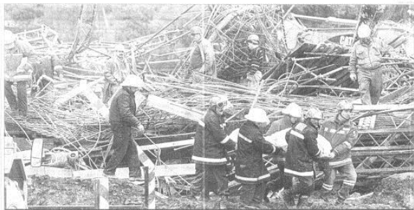
OS OPERÁRIOS, NOS FUNDOS, E DOIS GRUAS, FICARAM SOBREVIVENTES DE UM COLAPSO DE UMA VÉSTIBULA
