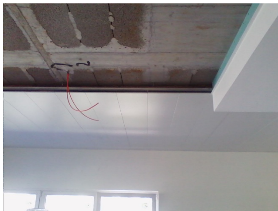
Figura 3.12 - Tetos falsos metálicos
