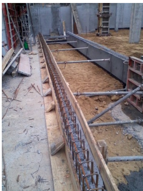
Figura 3.29 – Caleira de desenfumagem
