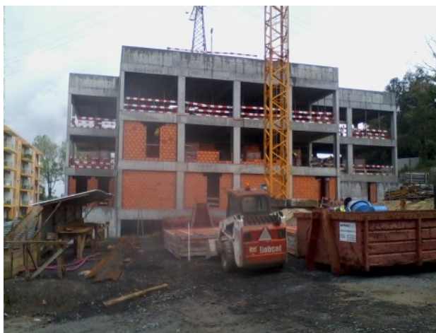
Figura 3.89 - Equipamentos de Proteção Coletiva
