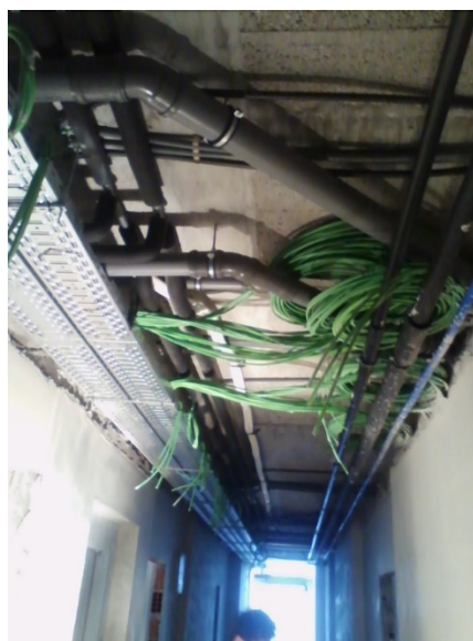
Figura 3.6 – Esteiras para caminhos de cabos
