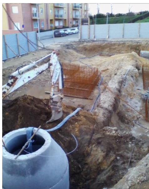
Figura 3.26 – Sistema de Bombagem
