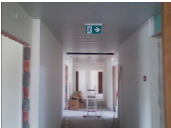
Figura 3.15 - Sinalização de saída de emergência
