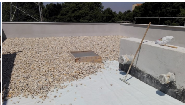
Figura 3.80 - Seixo rolado na Cobertura
