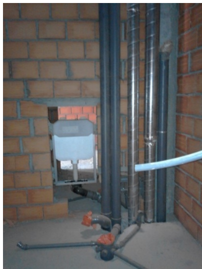
Figura 3.68 - Tubagens de saneamento
