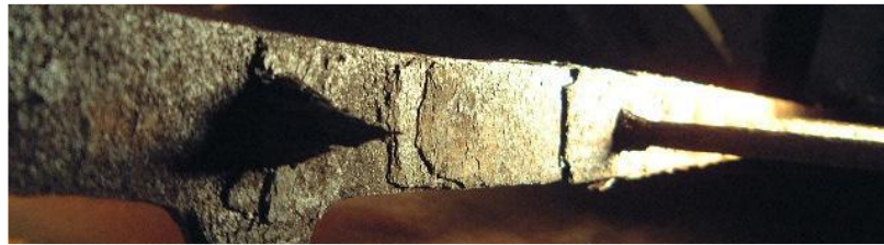
Figura 9 - Corrosão por esfoliação numa escada metálica [21].
