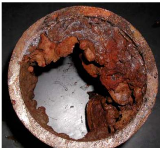
Figura 2 - Imagem de um tubo de material ferroso com protuberâncias de corrosão no seu interior [21].
