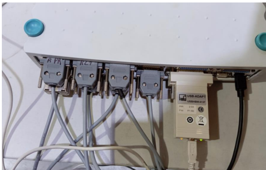
Figura 91 – Ligação dos cabos ao equipamento de aquisição de dados
