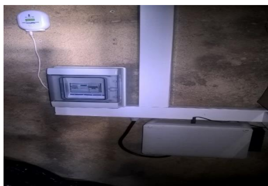
Figura 42: Quadro de proteção, sensor de monitorização de produção FV e quadro de gestão
