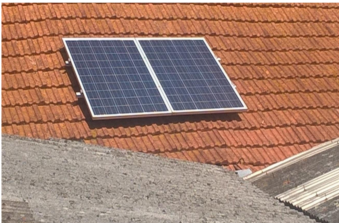
Figura 41: Painéis FV instalados em telhado inclinado da habitação em estudo
