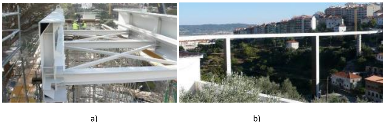
Figura 2.16 – Ponte pedonal sobre a Ribeira da Carpinteira; a) Pormenor da solução estrutural do tabuleiro; b) vista lateral (13)
