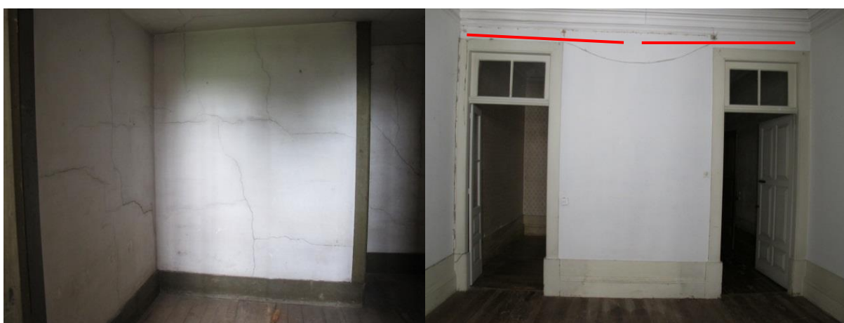
a) Fissuras existentes na parede de tabique do piso 3. b) Deformação da parede de tabique no compartimento CompA-2 do piso 2.
