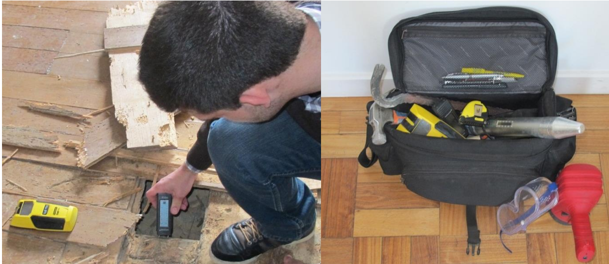
c) Sondagem no pavimento com auxílio do detector de metais e avaliação do teor em água com o higrómetro (NCREP, 2014c).
