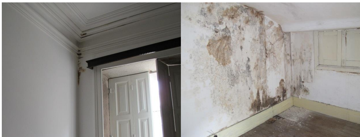
a) Identificação de entrada de água no piso 1. b) Ataque de fungos causados pela entrada de água observados na parede de empena do piso 2.
