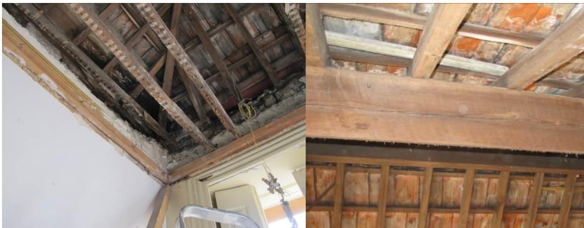
a) Degradação significativa nos frechais e rincões devido a elevada entrada de água na Cob1.
