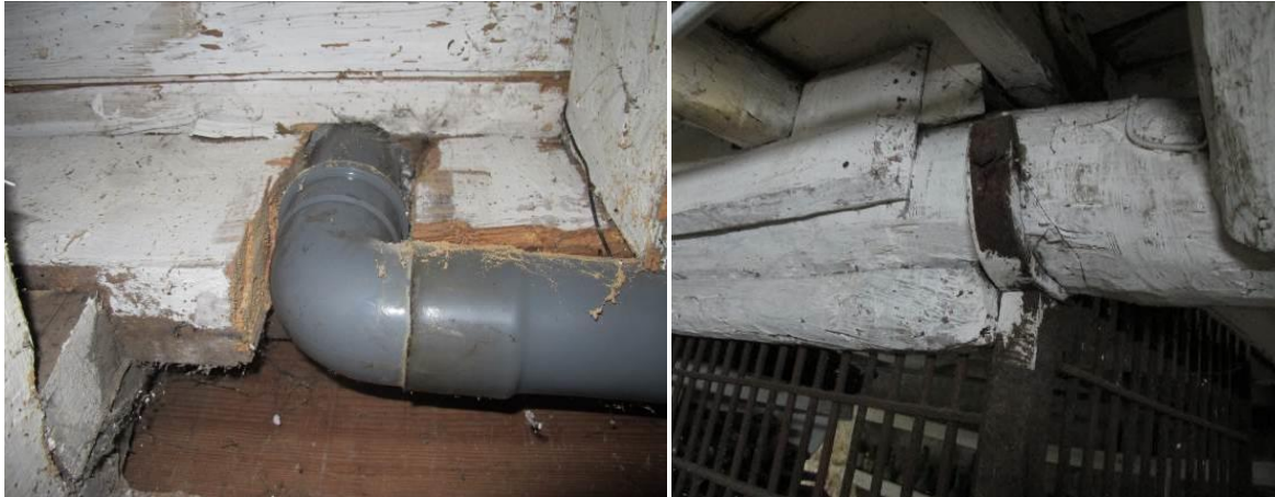
a) Corte do vigamento por intervenção descuidada. b) Corrosão avançada no prumo metálico.
