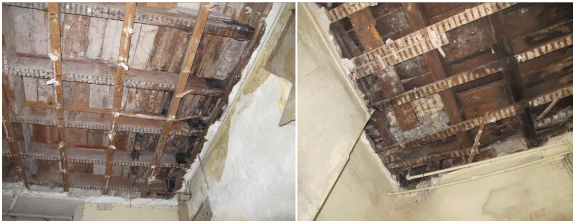
a) Degradação zona junto à fachada posterior do piso 1. b) Degradação na zona da casa de banho ao nível do piso 2.
