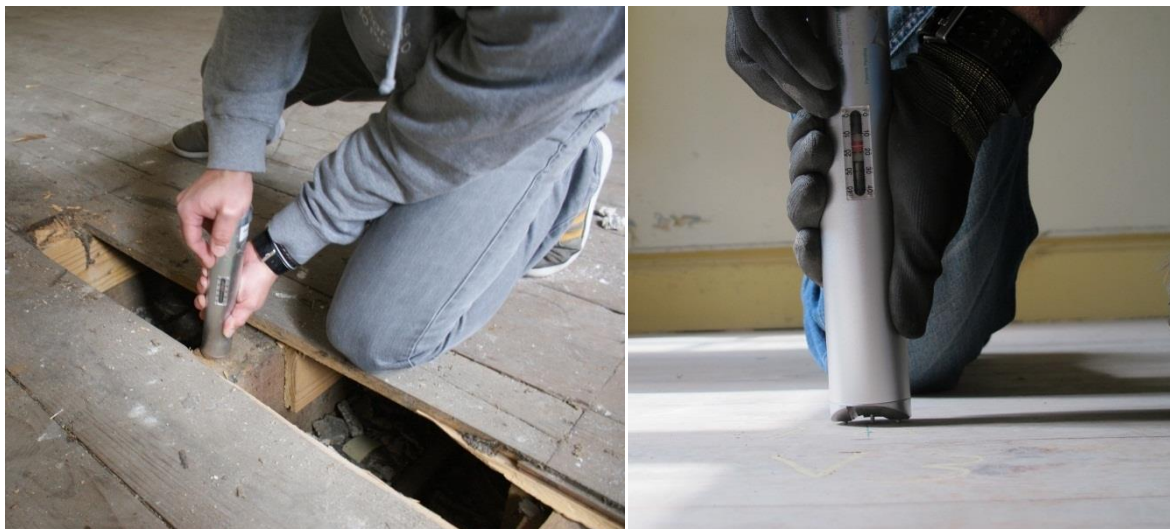
a) Realização do ensaio com Pilodyn na viga de pavimento, (NCREP, 2014g). b) Pormenor de ensaio, (NCREP, 2014g).
