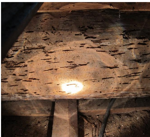
c) Degradação acentuada por insectos xilófagos (caruncho grande) em vigas de pavimento, (NCREP, 2014g).
