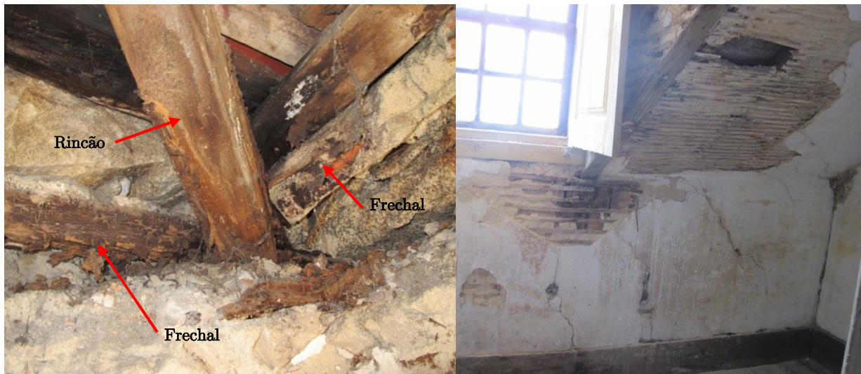
c) Degradação significativa por acção da entrada de água pela cobertura, (NCREP, 2014l) .
