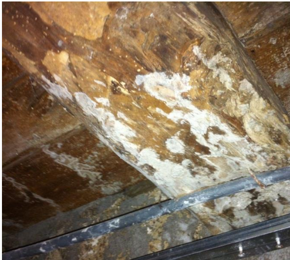
a) Presença de fungos xilófagos em viga de pavimento, (NCREP, 2014b).
