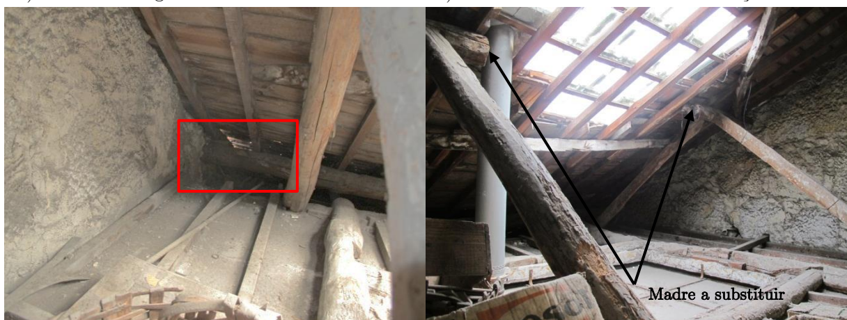
c) Apoio da madre junta a clarabóia degradado.
