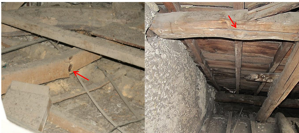
a) Rotura do elemento de madeira por existência de nó junto ao apoio, (NCREP, 2013b). b) Fenda de secagem existente em madre de cobertura, (NCREP, 2014c).
