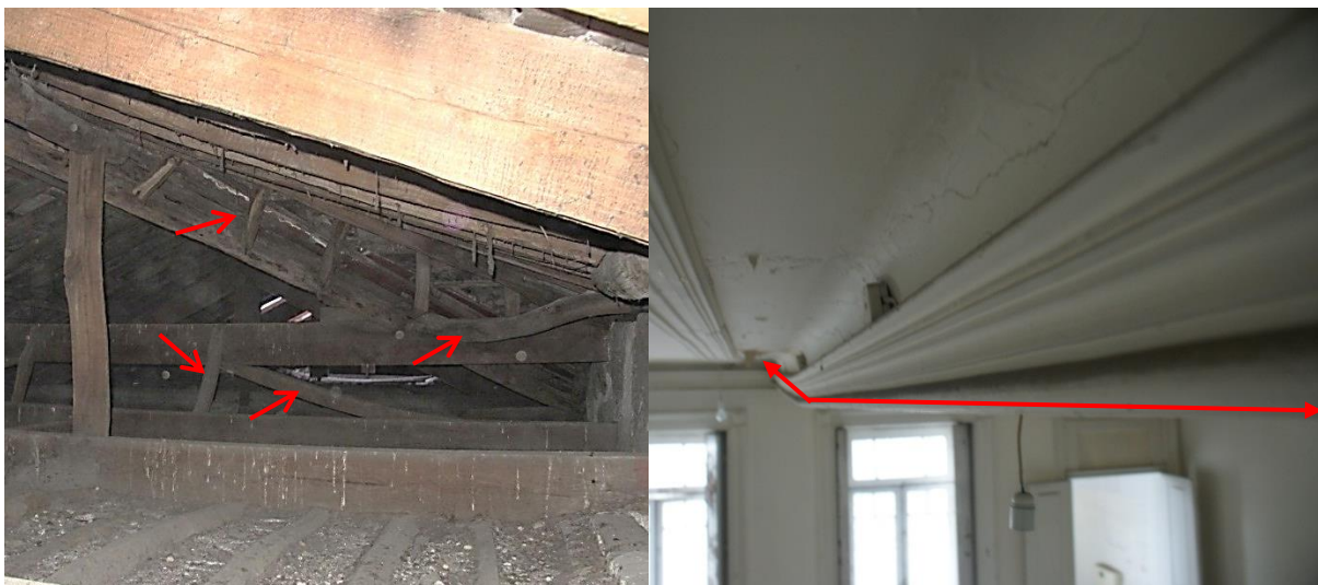
a) Deficiente disposição construtiva dos elementos estruturais da cobertura, (NCREP, 2014f).
