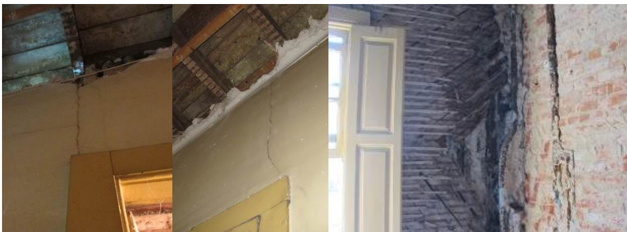
a) Fissuração do tabique interior ao nível do piso 0. b) Degradação no tabique exterior do piso 2.
