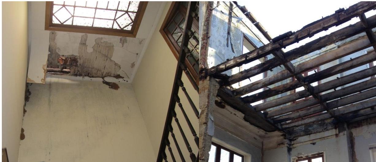
a) Degradação e ataque biótico pela elevada entrada de água, (NCREP, 2014f).
