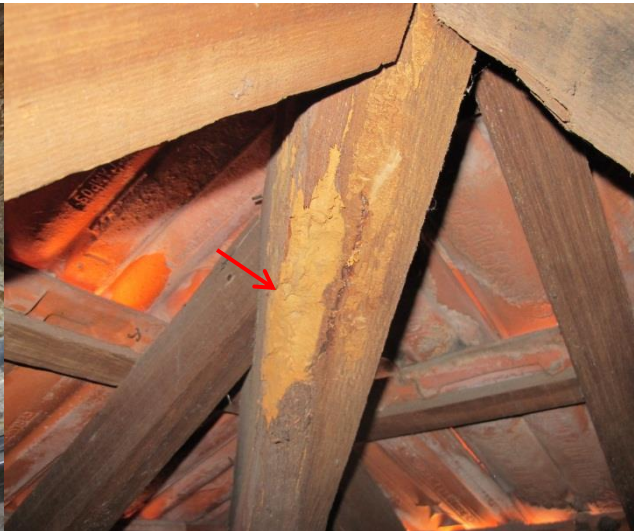
b) Degradação por ataque de insectos xilófagos (caruncho grande) em elementos da cobertura, (NCREP, 2014e).
