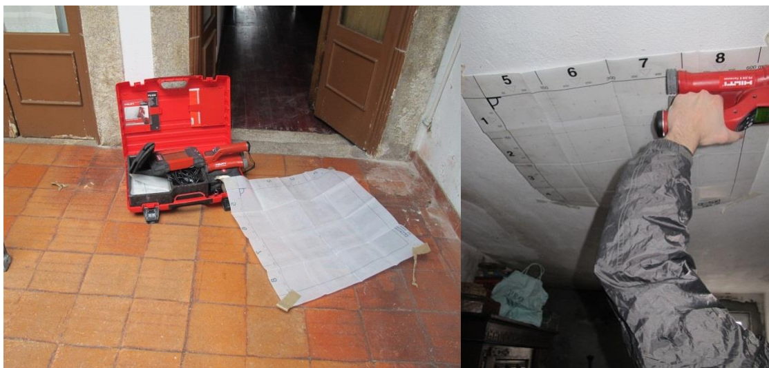
a) Ferroskan PS200 utilizado nas campanhas de inspecção/diagnóstico, (NCREP, 2014c). b) Detecção de armaduras com Ferroskan PS200 em laje maciça, (NCREP, 2014c).
