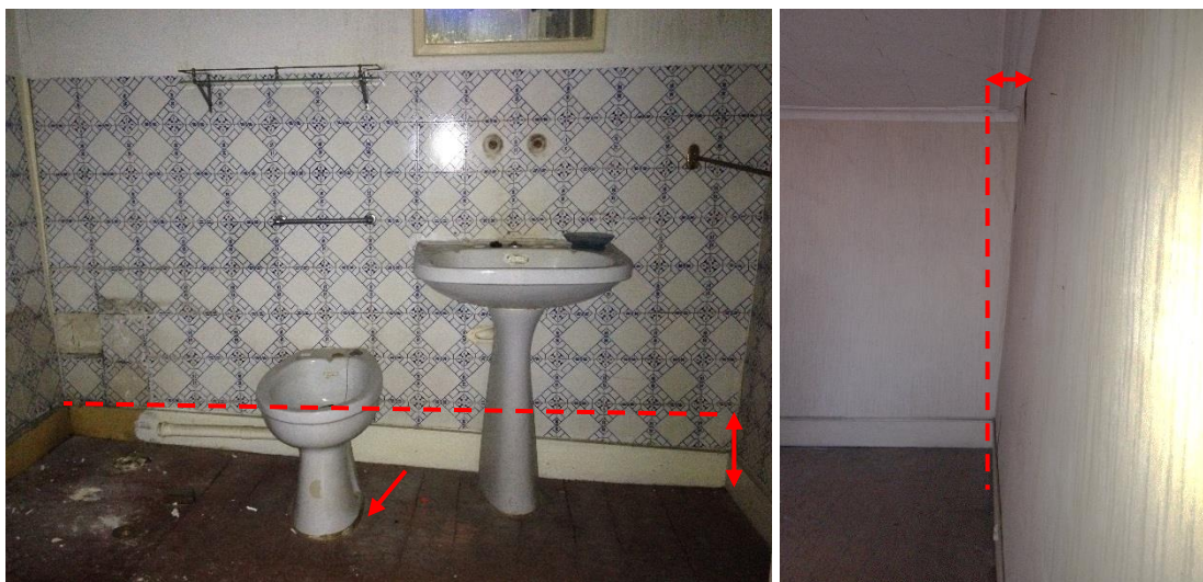
a) Deformação do pavimento de madeira.
