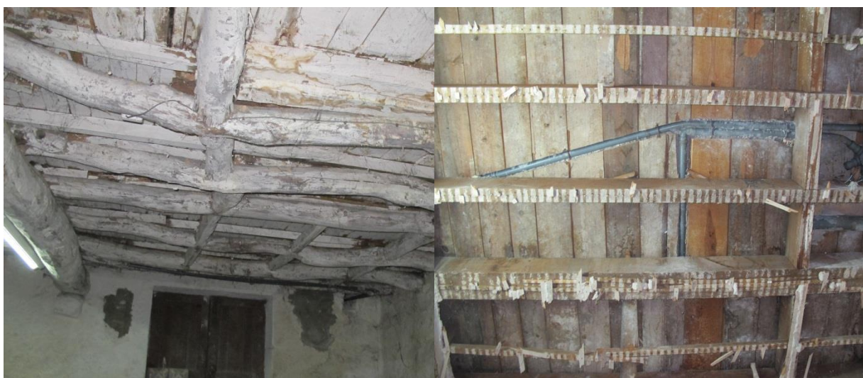
a) Pormenor das vigas circulares no pavimento do piso 0. b) Pormenor das vigas rectangulares no pavimento do piso 1.
