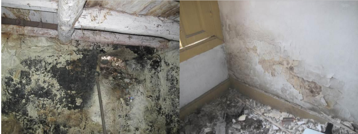
a) Ataque de fungos causados pela entrada de água observado na parede de empena do piso -1. b) Identificação de entrada de água na alvenaria de tijolo maciço do piso 2.
