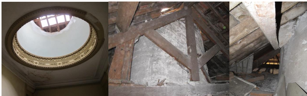
a) Vista pelo interior do edifício. b) Pormenor dos elementos de suporte.
