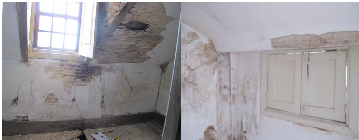
a) Degradação das paredes de tabique exteriores ao nível do piso 3. b) Degradação na fachada principal do compartimento CompA-2 do piso 2.
