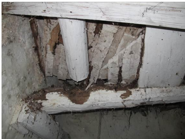
c) Colapso parcial do pavimento de madeira.
