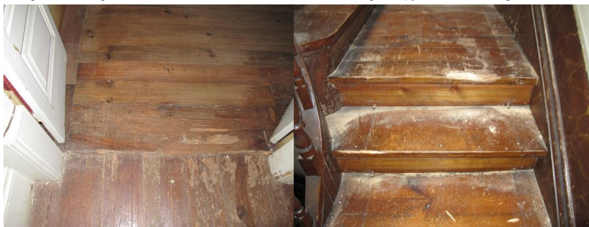
c) Soalho duplo em mau estado no compartimento CompB-1
