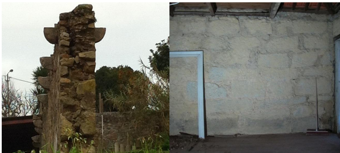
a) Parede de pano duplo, (NCREP, 2012b). b) Parede de empena em pano simples, (NCREP, 2014j).
