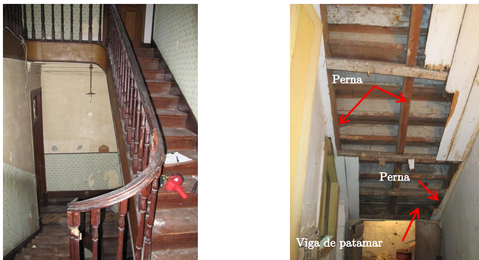
a) Escadas de dois lanços, (NCREP, 2014h). b) Esquema estrutural, (NCREP, 2014l). Figura 13 – Escadas representativas dos edifícios em estudo.
