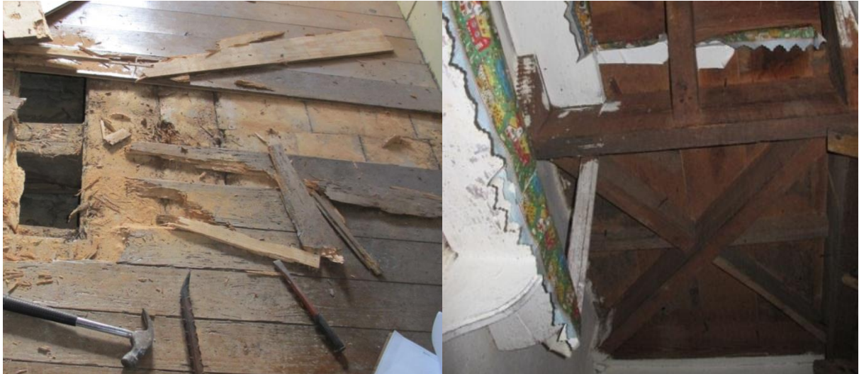
a) Soalho duplo existente no piso 2 junto a fachada principal. b) Pernas e vigas cruzadas dos patamares da escada central.
