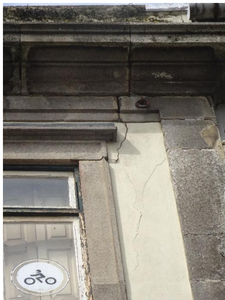
a) Fissuração nos elementos de cantaria e da fachada
