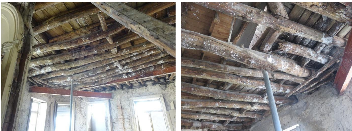
Figura 4.13- Coloração do vigamento do piso 3 provocado pelo ataque de agentes bióticos
