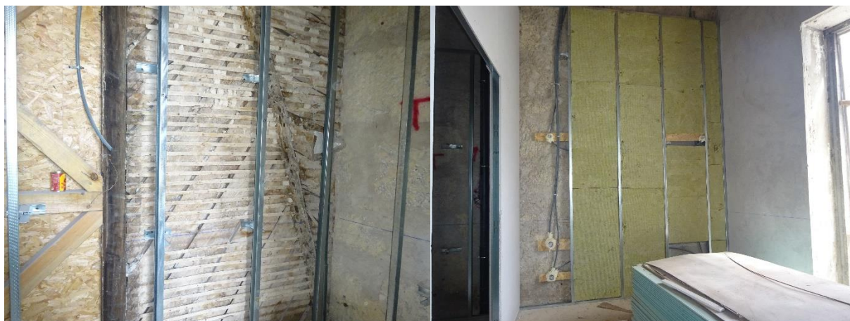
a) Parede divisória interior de frontal de madeira (à esquerda) e tabique (à direita) com montantes de aço
