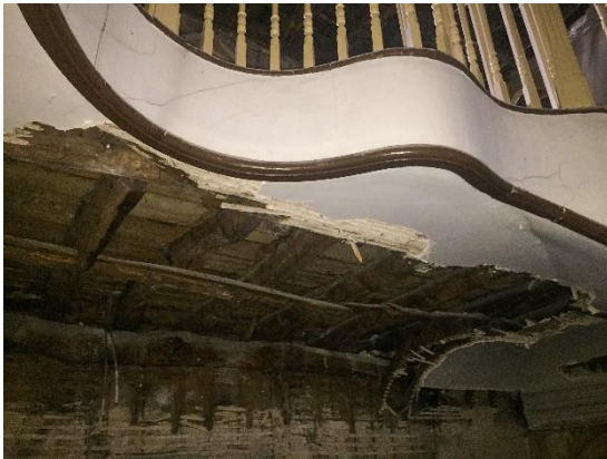
a) Estado de degradação do teto do rés do chão
