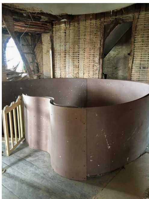
a) Guarda-corpos da escada protegido com “platex”
