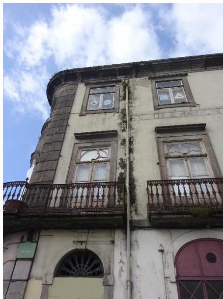
b) Sujidade e destacamento da pintura da fachada
