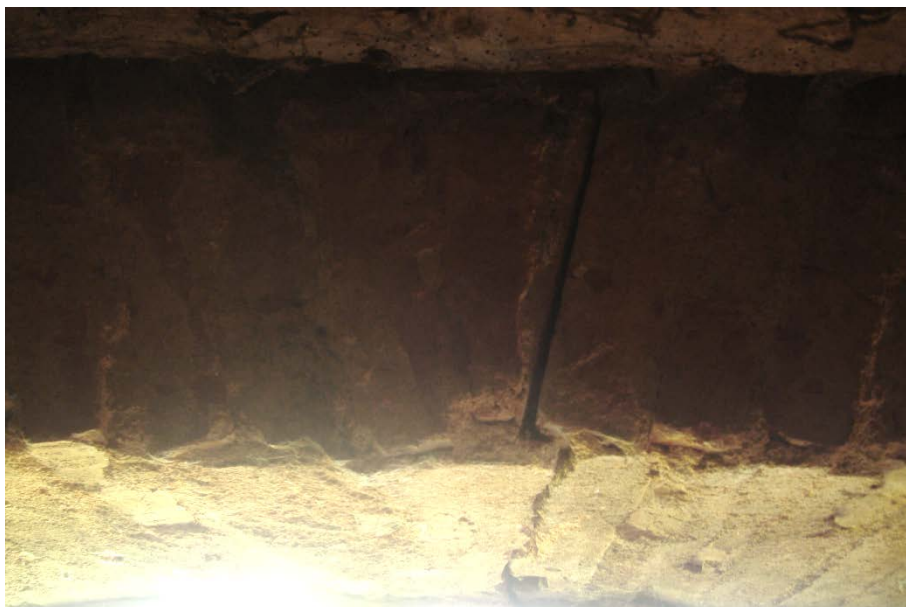
Figura 17 - Padieira da porta principal a reforçar com elementos metálicos
