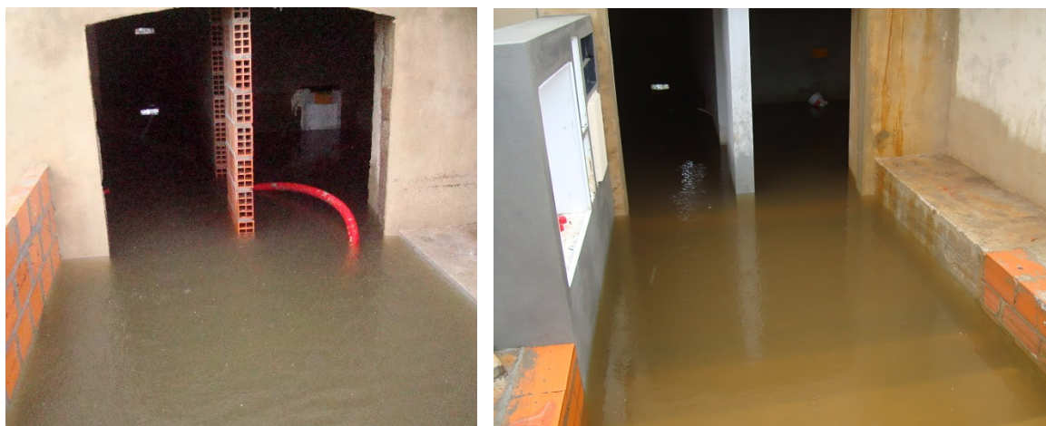
Figura 92 - Inundações em fases distintas da obra
