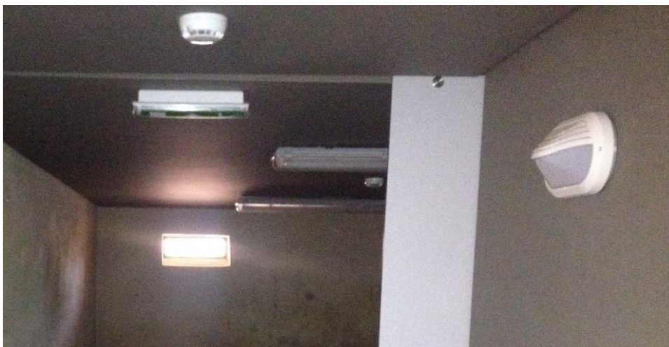
Figura 91 - Equipamentos de detecção de incêndios, sinalização da saída de emergência e aparelhos de iluminação
