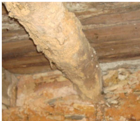
Figura 35 - Estado de degradação das vigas existentes
