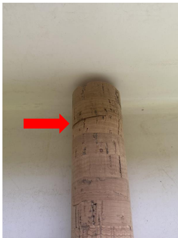
Figura 23 – Tubo defeituoso identificado.
