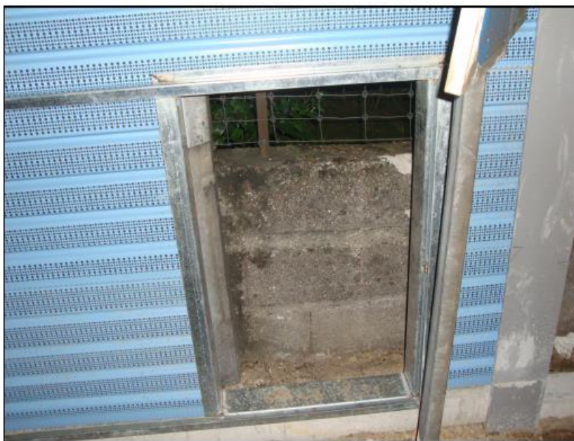
Figura 4-17 – Janela de acesso à portilha do poste de iluminação pública;
