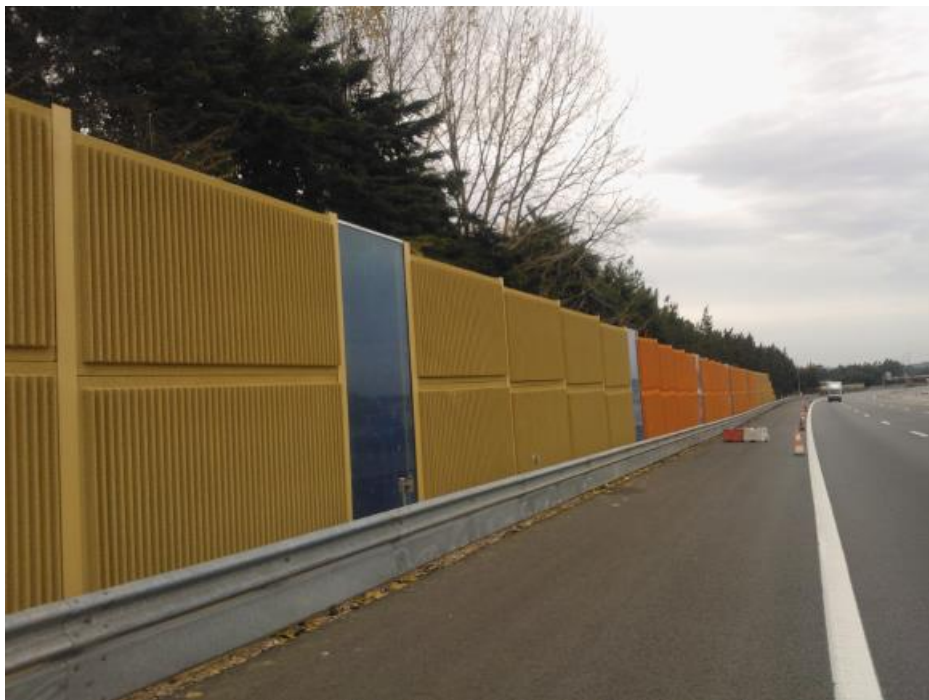
Figura 3-5 – Barreiras acústicas em betão poroso;
