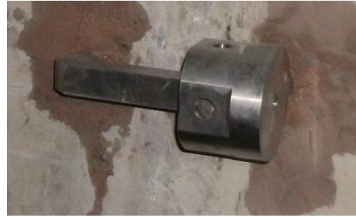
Figura 33 – BT instalada na barragem
