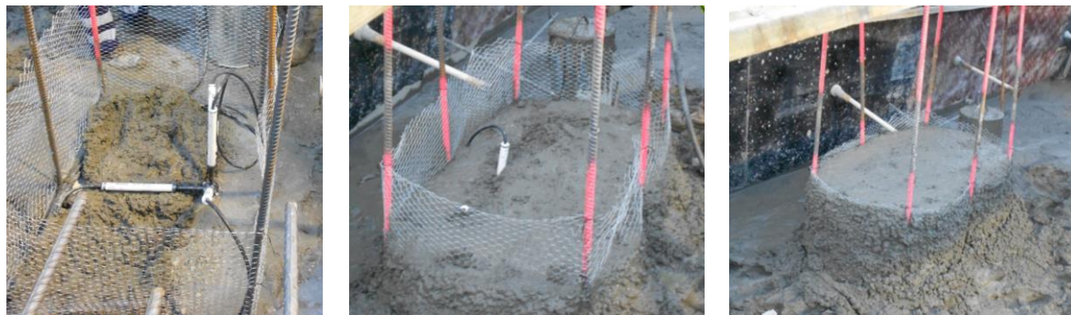
Figura 86 – Envolvimento de grupo plano de extensómetros de resistência com rede de galinheiro
