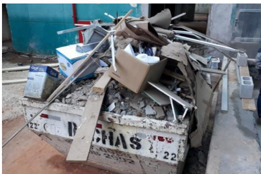
Figura 8.46 – Caçamba com RCD depositados sem algum critério de triagem
