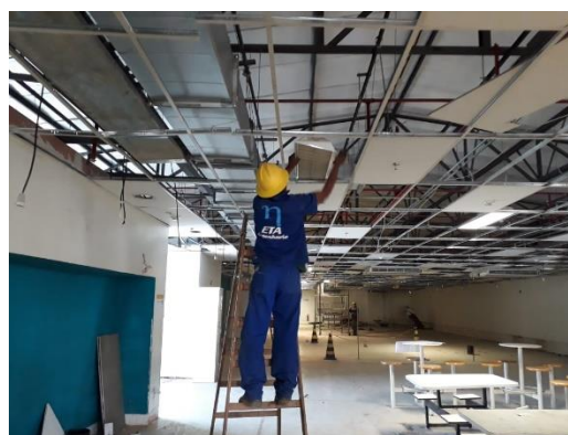
Figura 8.17 – Readequação do layout das luminárias
