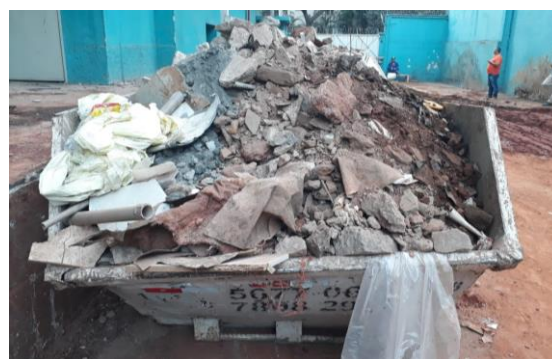
Figura 8.49- Caçamba com RCD depositados sem algum critério de triagem
