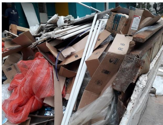
Figura 8.34 – Luminárias descartadas junto aos demais resíduos nas caçambas
