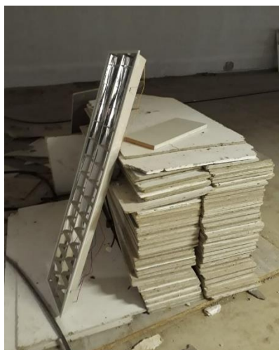
Figura 8.22 – Placas de forro mineral danificadas durante armazenamento inadequado
