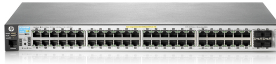
Figura 36 Switch HPE Aruba 2530-48G
