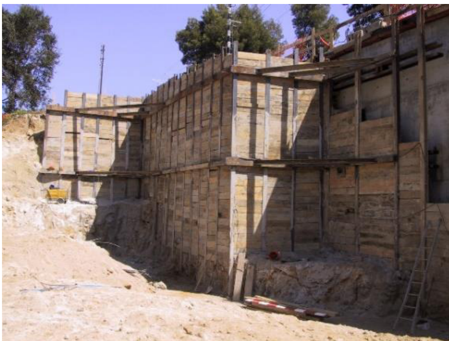
Figura 2.2 – Parede tipo Berlim escorada, de carácter provisório, constituída por pranchas de madeira e perfis metálicos.
