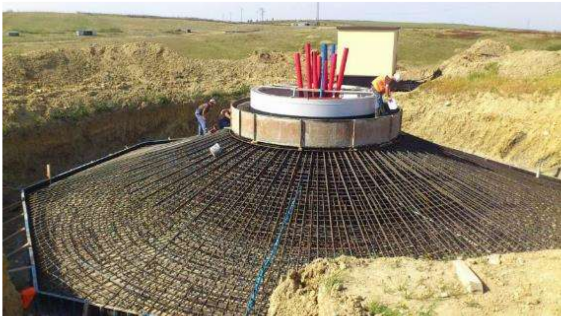
Figura 57 – Estrutura da armadura e cofragem na parte inferior e superior da fundação
