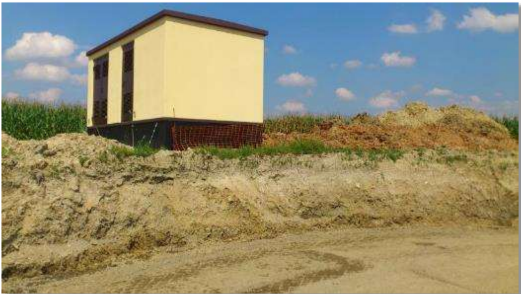
Figura 47 – Estação de Comutação de um aerogerador ( kyobet )
