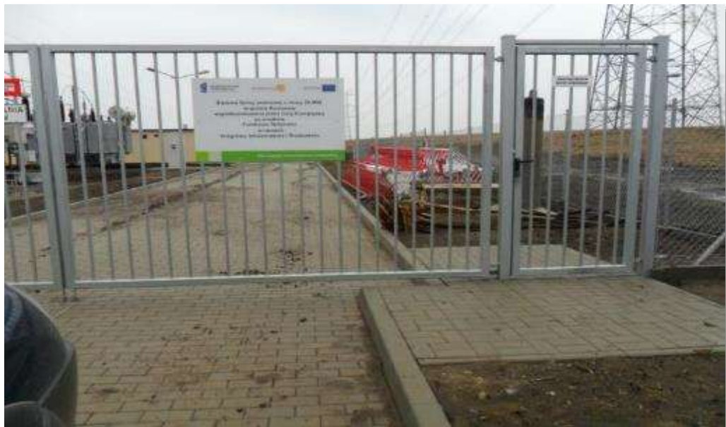
Figura 50 – Vedação e arranjos exteriores da área da Subestação
