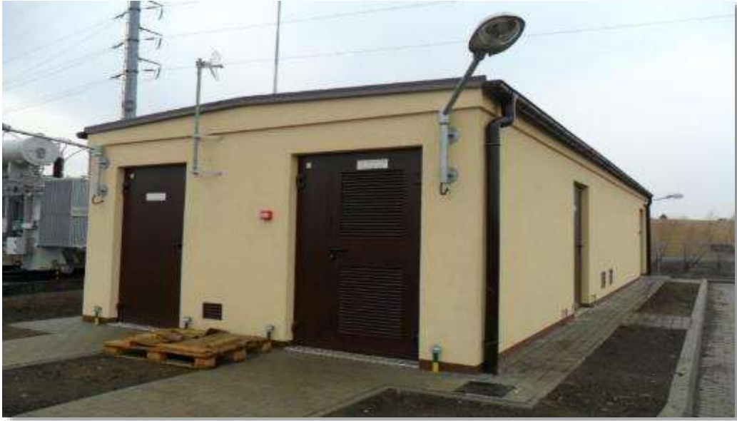
Figura 48 – Estação de Comando
