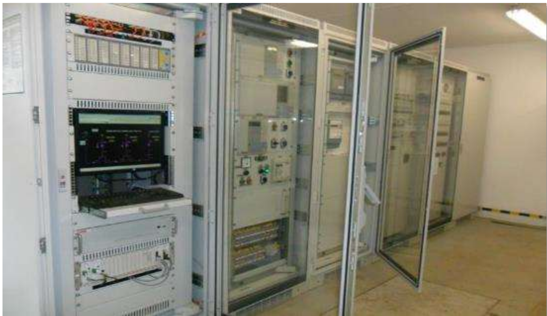
Figura 51 - Controlo remoto dos aerogeradores instalado na Subestação
