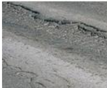
Imagem 20 - Elevação parcial do pavimento.
