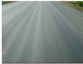
Imagem 21 - Ondulações no pavimento.
