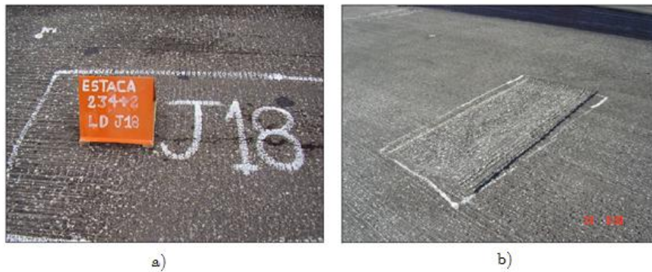
Imagem 30 - Janela cadastrada. a) Exemplo de janela após fresagem. b) Exemplo de janela após segunda fresagem.
