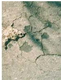
Imagem 22 - Desincrustação do pavimento.
