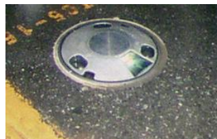
Imagem 54 - Luz aeronáutica superficial encastrada.
