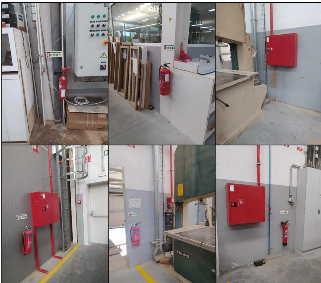
Figura 43 – Limpeza e organização dos extintores e mangueiras
