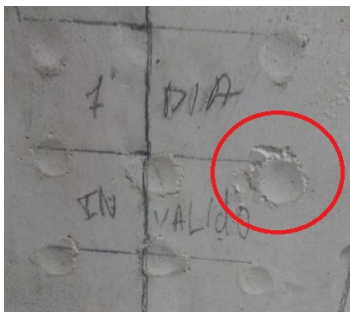
a) Vazio criado no ponto 8 na área de ensaio da lajeta sem armadura da amassadura 2
