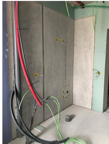
Figura 4.16 -Placa de gesso cartonado tipo Solidtex na zona da cozinha (Autor do trabalho)
