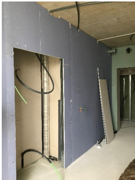
Figura 4.15 -Placa de gesso cartonado de alta dureza colocada nas costas do WC (Autor do trabalho)
